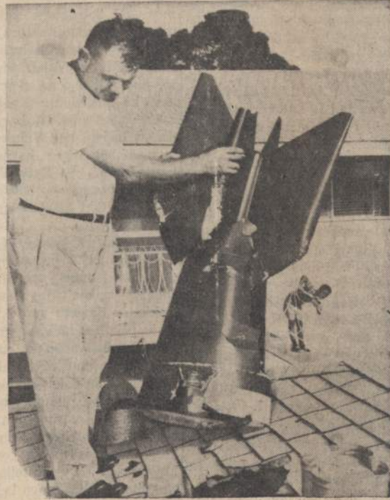
Coronado, Calif. — Valdininkas Sherman Brewe apžiūri pramuštą stogę skylę, kurią padarė sproausminio lėktuvo velkamas taikinyks, kai nutruko kabelis. Apylinkės gyventojai sako, jog į stogę trenkęs taikinyks padarė tokį garsą, lyg būtų įvykusi eksplozija. Iš gyventojų niekas nenukentėjo.
